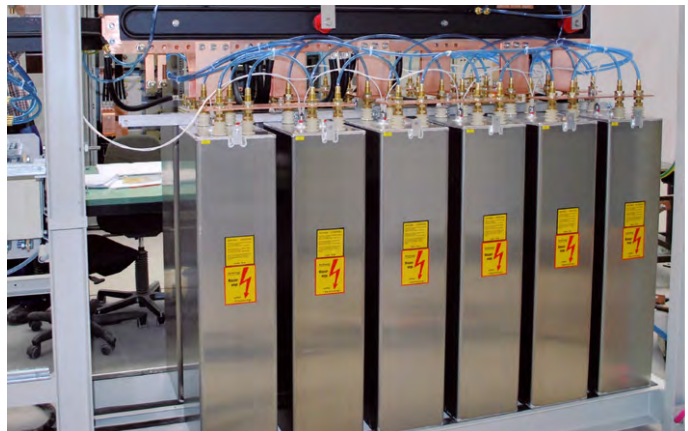
Leistungselektronik mit Wasserkühlung
